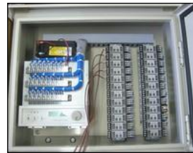
●変換器24個を制御盤に組み込み
