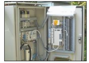
●計装盤への組み込み
