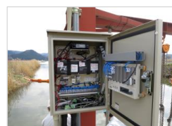
無線機組込盤
