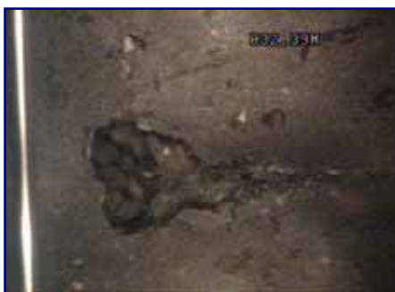
ケーシング接続部腐食状況
