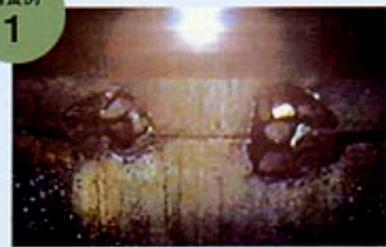
ケーシングに直径3cm程度の穴が2ヶ所空いた状況
