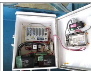
遠隔監視盤(24CH ロガー)
