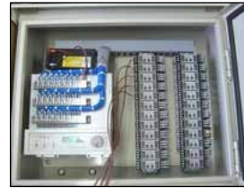
熱電対変換器を24個、制御盤に組み込んだ例
